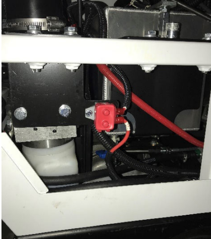
Cooling Fan Circuit Breaker
